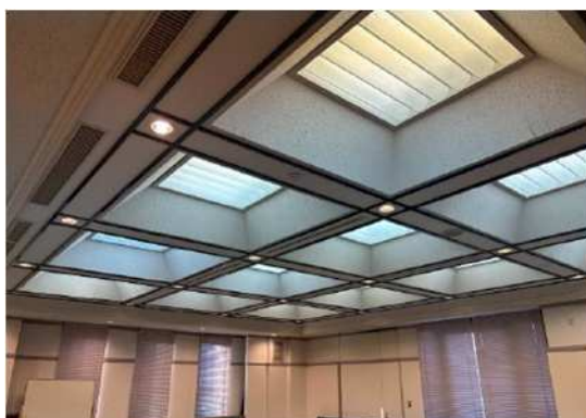
更新前 蛍光灯
